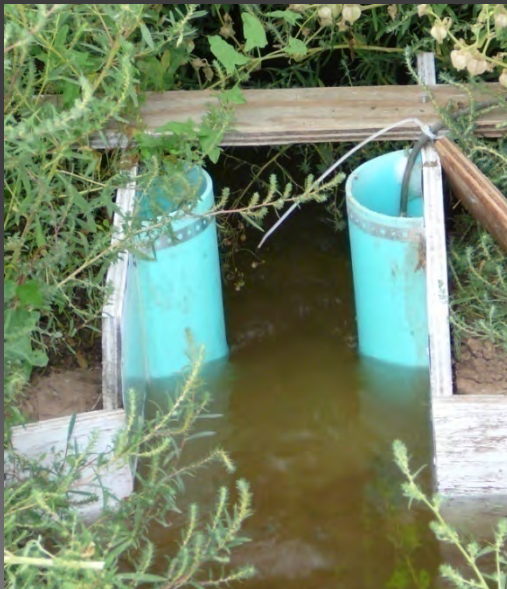
S-M flow meter
